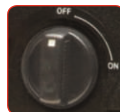
Interruttore staccabatterie Battery switch
