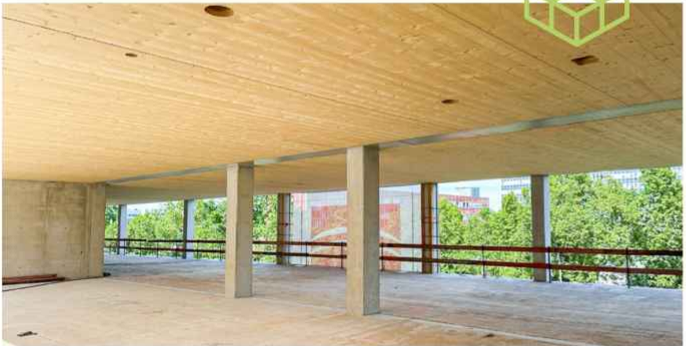
Die unterzugfreie Deckenkonstruktion mit großen Spannweiten schafft großzügige Freiräume und erleichtert spätere technische Installationen.
