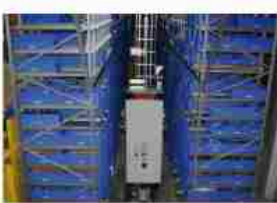
AUTOMATISCHES KLEINTEILE LAGER (AKL)
